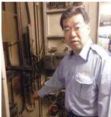
水没した機械室の様子を確認する山田知事
